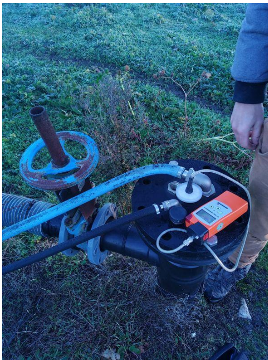
Figure 37. Mesure de la composition de biogaz au sein d'un puits mixte.
