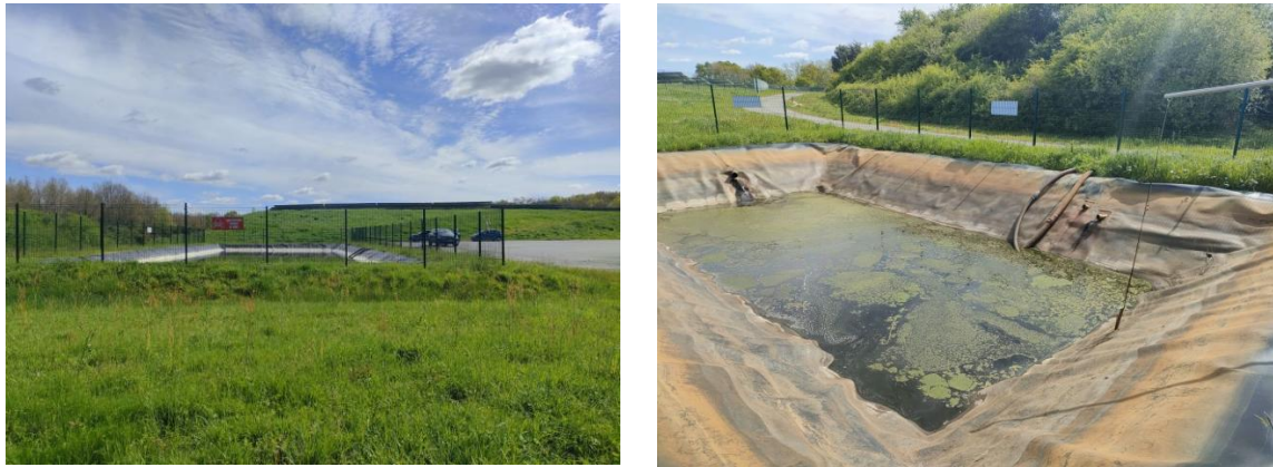
Figure 4. Bassin de collecte des lixiviats de la zone 1 (photo de gauche) et de la zone 2 (photo de droite).
