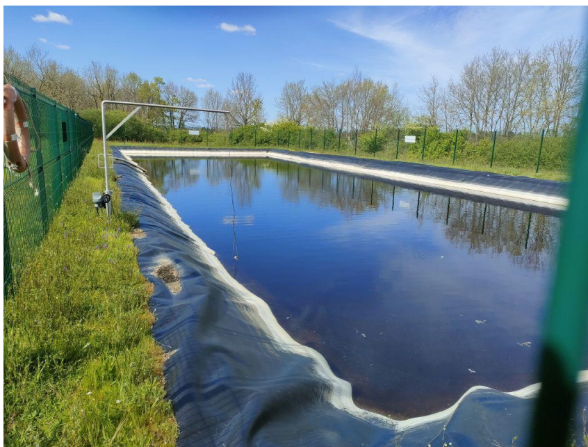
Figure 21. Bassin de stockage des lixiviats issus de la zone 1.
