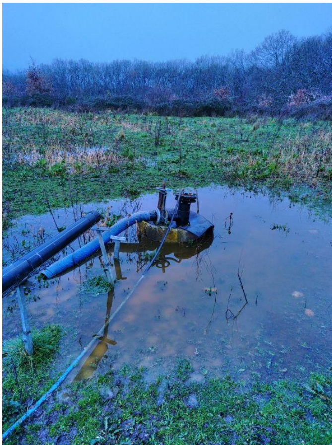
Figure 26. Tête de puits 3.
